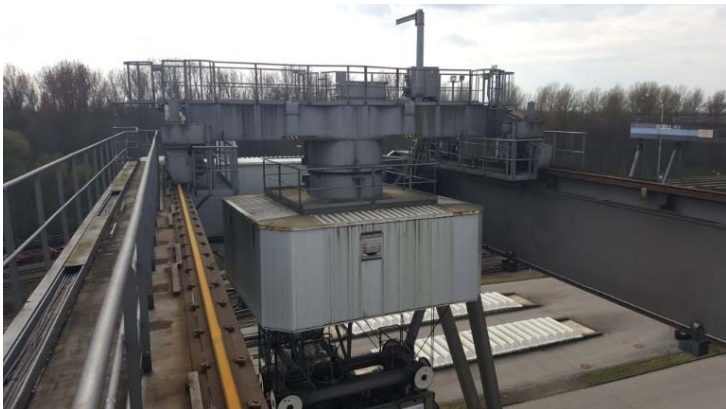
Kran 1: Krankatze mit Maschinenhaus
